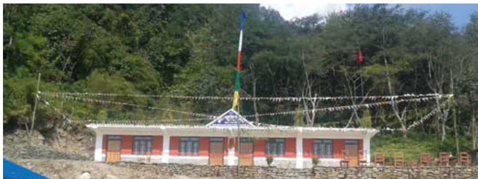
Shree Sundar Primary School di Sadan, Phulkharka inizio lavori febbraio 2016 e consegnata ottobre 2016
